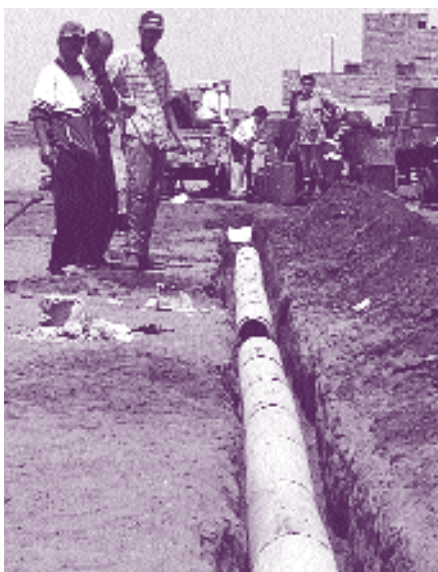
Travaux de mise sous tuyau des eaux usées avec la participation des habitants du lotissement Souk Es Sebt
