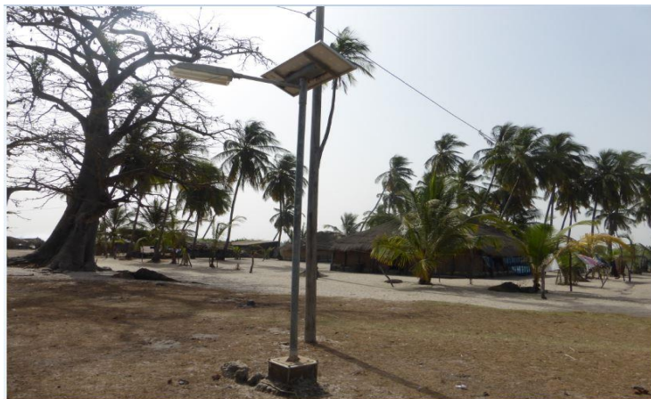
Photo 3: un lampadaire solaire installé par ASER à Carabane
