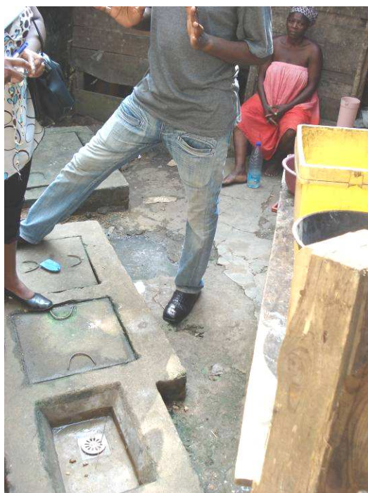
Ouvrage d'évacuation des eaux usées à Edéa, Cameroun.
